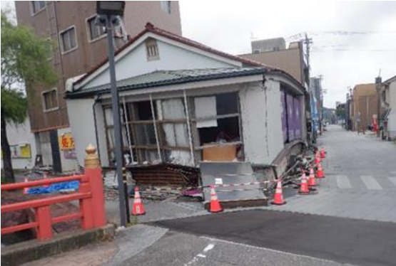
石川県七尾市の被害状況
